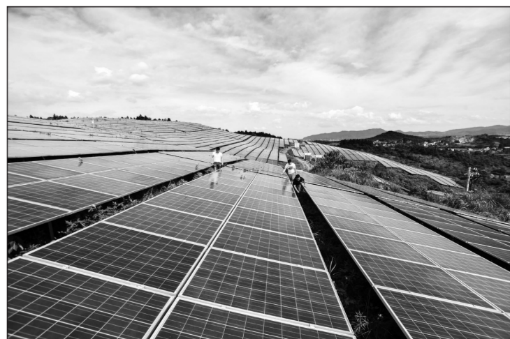
江西省新余市近年来充分利用荒山、尾矿库、屋顶和水面等资源,大力发展光伏发电项目。自2012年以来,新余市已建成并网发电项目360兆瓦,有效利用了荒山、荒坡600余亩,尾矿库、水面4200余亩,屋顶面积190万平方米。 人民图片网供图
