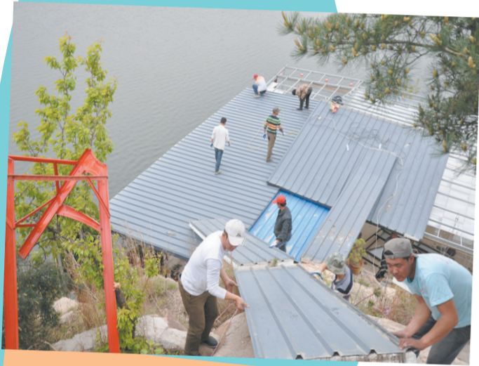
图为济南市南部山区黄巢水库周边一处违建建筑,业主正在组织自拆。董若义摄
