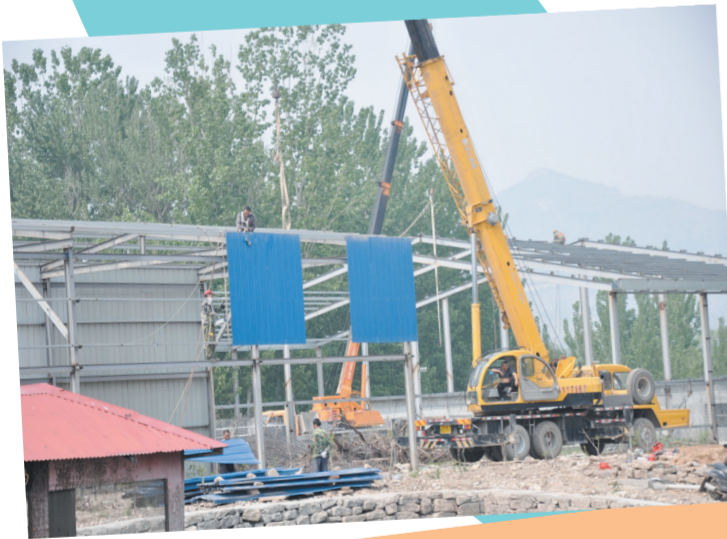
图为济南市南部山区仲官街道正组织人员、机械对卧虎山水库下游玉符河沿岸农家乐等违建设施进行集中拆除。董若义摄
