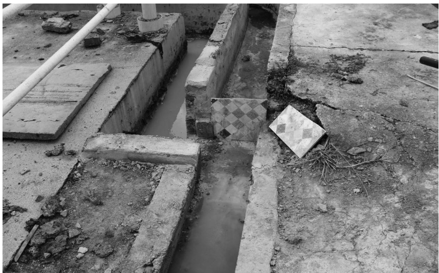
临高橡胶厂雨水排放口和污水排放口仅用一块瓷砖阻隔。
