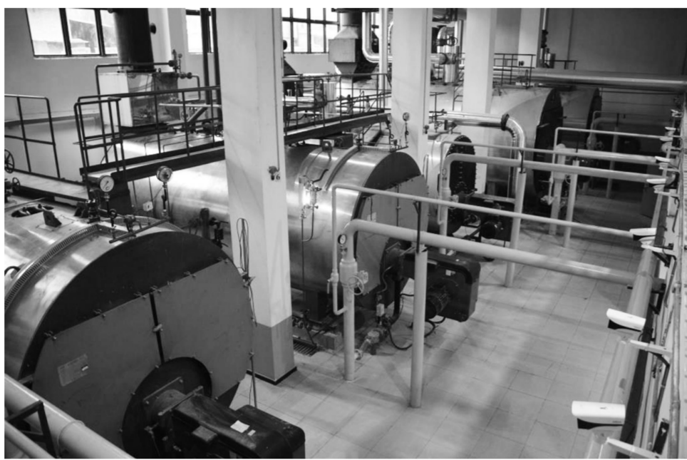
拆改后焕然一新的天然气锅炉房干净整洁。
