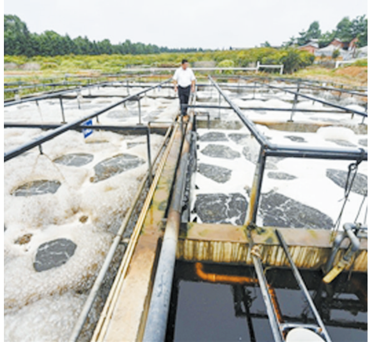
江西省新余市全力推进畜禽养殖专项整治工作,坚决做好禁养区养殖场的关停拆除工作,加快可限养区的生态化改造步伐。截至目前,全市关停拆除禁养区养殖场6265家,完成可限养区关停、拆迁或改造养殖场565家。图为一家养殖企业投入220多万元,建成集水井、固液分离系统、酸化调节系统、全厂氨氮系统和工业化深度污水处理等系统,实现养殖废水的循环利用。 黎燕平 周亮
