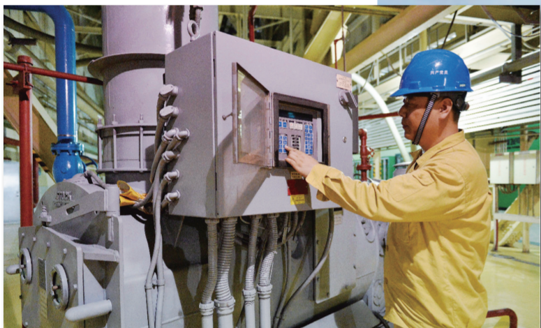
加强重点行业大气污染治理。截止2017年6月,全国燃煤机组累计完成超低排放和节能改造5.7亿千瓦,占全国煤电装机容量的60%。图为京津冀首台超低排放燃煤机组通过验收并投产。
