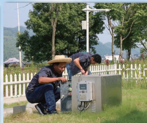
加快农村环境综合整治。截至2016年底,完成约11万个村庄环境综合整治,约1.9亿人受益。图为浙江省安吉县运维人员检查农村生活污水处理设施。
