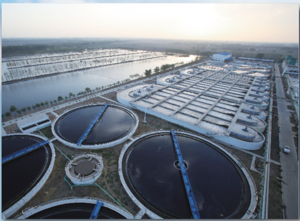
狠抓工业污染防治。专项整治十大重点行业,集中治理工业集聚区水污染,2015年工业化学需氧量和氨氮排放较2010年分别降低30%和20%。图为采用氧化沟工艺和催化絮凝沉淀工艺处理生产废水。
