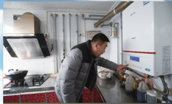
加快散煤污染治理。2016年京津冀大力推行煤改气、煤改电工程,完成80万户散煤替代工作,削减散煤消耗约200万吨。图为河北省固安县高王起营村一位村民使用天然气取暖。
