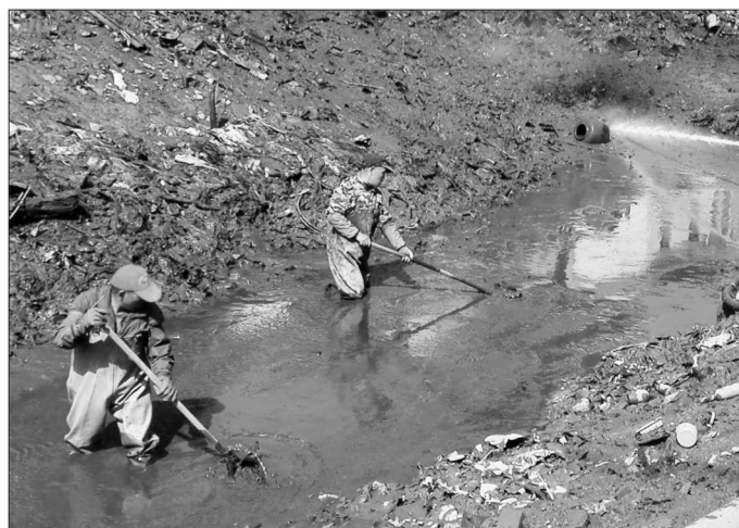
江苏省苏州市黑臭河道治理“扩面提速”,治理范围从城市市区建成区延伸到城镇建成区,从苏州城区覆盖到各县市区,并且力争到2018年底,比国家“水十条”要求的时限提前两年基本消除全市城镇建成区黑臭水体。目前,列入今年整治计划的40条市县级黑臭水体正加紧整治,列入2018年整治计划的82条市县级黑臭水体已有57条提前开工。图为昆山市二号中心河正在清淤。
