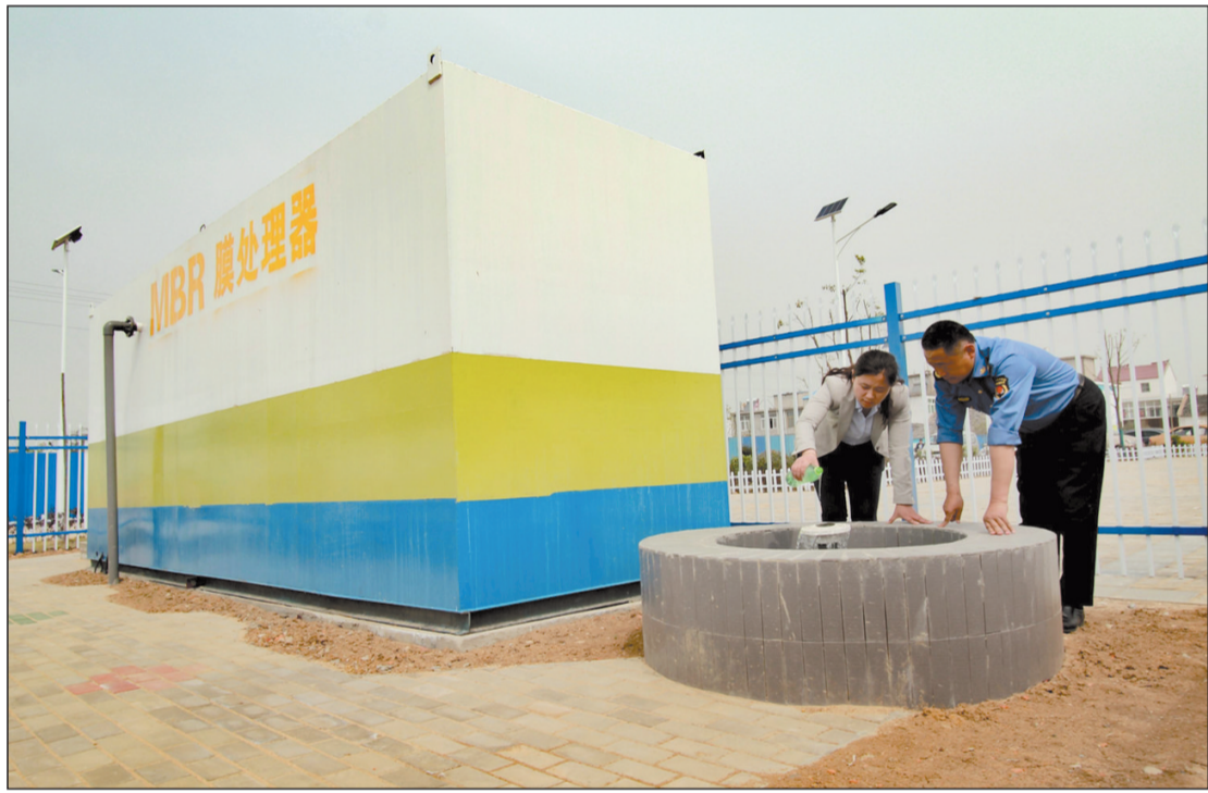
去年以来,安徽省肥东县投入2000多万元,在全县8个乡镇12个中心村建立15座污水处理设施,日处理污水可达1080吨。当地居民将日常生活污水引入调节池,污水处理后流经人工湿地再次净化,最后实现达标排放。图为管理人员正在查看污水设备运行情况。 人民图片网供图
