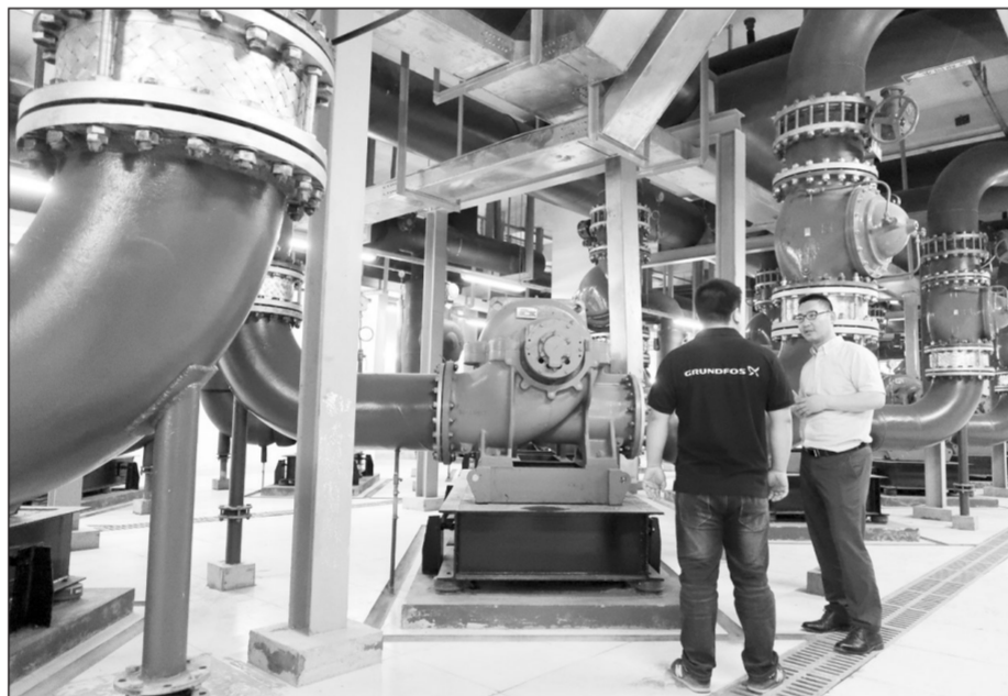
重庆市渝北区中渝国际都会“新光天地”项目日前通过了美国绿色建筑LEED认证。近年来,重庆市把培育绿色建筑作为转变发展方式重要抓手,计划出台绿色建筑推广实施方案。图为“新光天地”暖通项目经理在格兰富中央空调水泵系统前检查设备运行情况。本报记者邓佳摄
