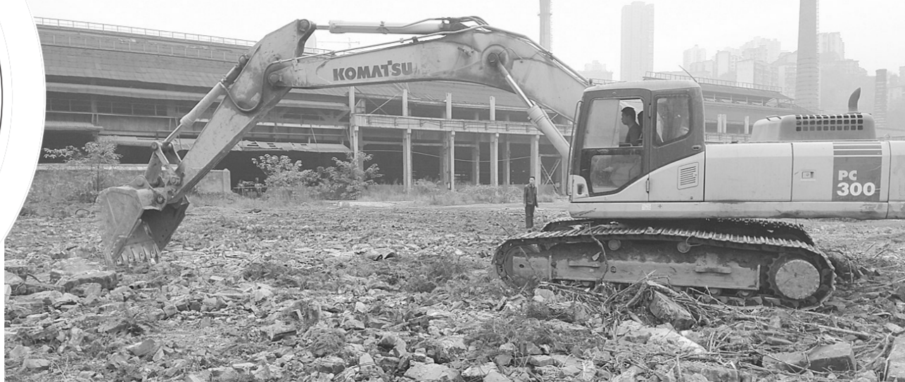
▲因为重庆市大渡口区重钢老厂原址,挖掘机正在作业,以便进行土壤修复工作。
