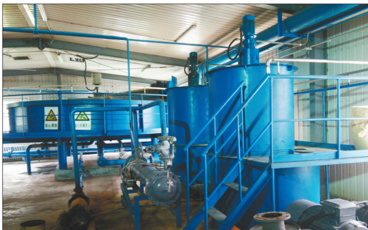
完达山阳光乳业有限公司污水处理示范工程现场。
