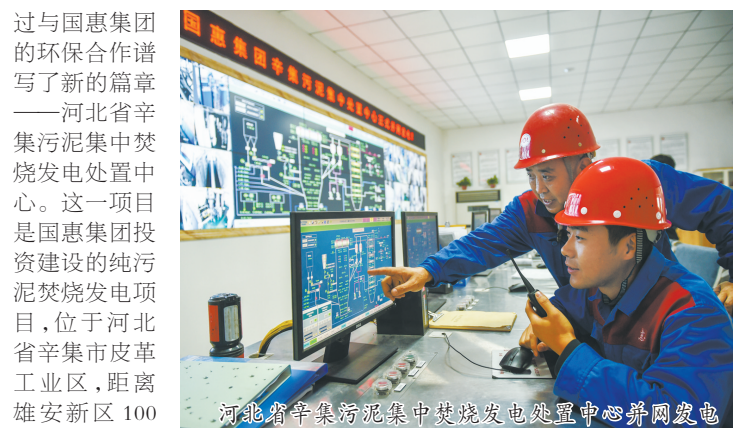
河北省辛集污泥集中焚烧发电处置中心并网发电
