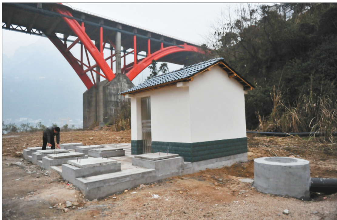
湖北省宜昌市夷陵区乐天溪镇、莲沱集镇两个微动力污水处理站将于近期投入使用,工作人员近日对污水处理设施进行检验检查。近年来,宜昌市夷陵区将农村污水处理列为生态治理攻坚重点,除实现12个乡镇(街道)污水处理厂全覆盖外,还建设了369个农村微动力及无动力污水循环处理设施。 张国旗摄
