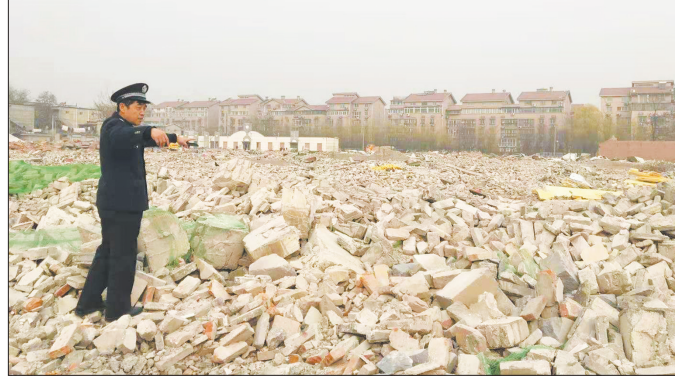
刘平在北京市空气重污染应急执法期间,发现海淀区阜石路一处大面积拆迁裸地未采取苫盖措施。
