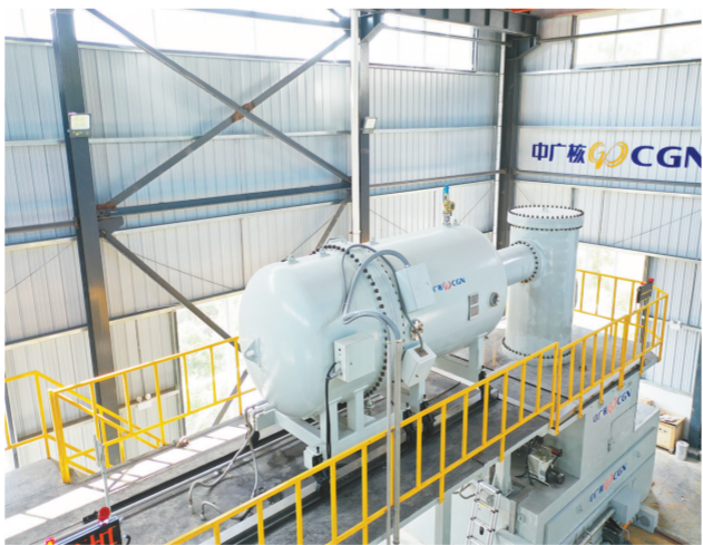
图为电子束辐照处理医疗污水示范项目 中广核供图
