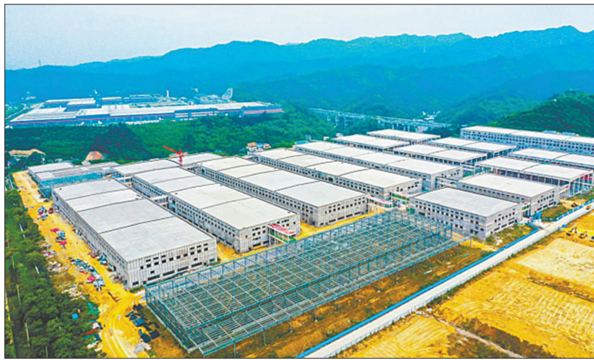
远景零碳智能电池产业园项目是湖北省十堰市与远景科技集团签署战略合作框架协议的重点项目之一,总投资120亿元,一期建设20GWh智能电池项目。项目建成后,将进一步推动十堰市传统汽车优势产业转型升级,促进新能源汽车产业链延链补链强链,形成以绿色能源为支撑,打造零碳汽车出口基地。图为在十堰市张湾区远景零碳智能电池产业园项目现场,目前企业厂房主体结构基本完工,水电气等配套设施建设正有序推进。
