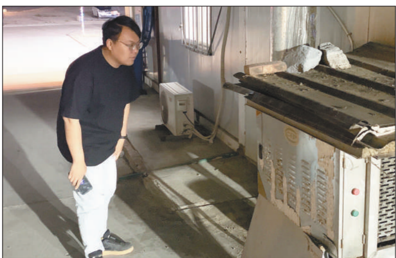
图为潍坊市高新区环委办督查组工作人员现场检查餐饮油烟治理设施运行情况。李俊杰摄
