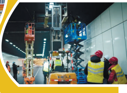
▼图为工程技术人员正在为南京市草场门隧道开展设备吊装工作。
