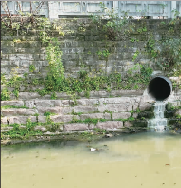
沙坪坝区龙凤河陈家桥街道朱家桥段至虎溪河沙坪坝段有排口在晴天排污。
